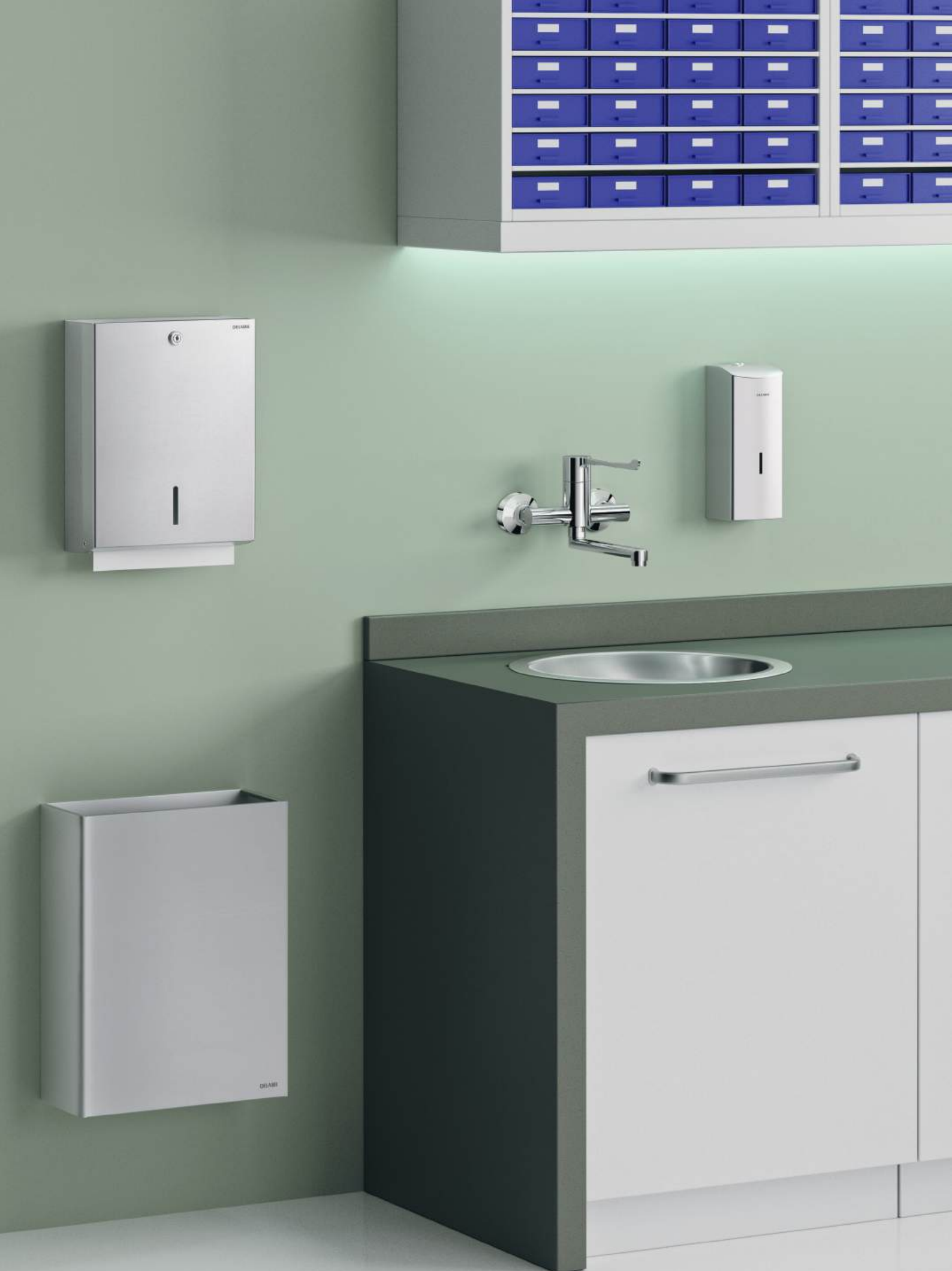
Sekwencyjna bateria mechaniczna do montażu na ścianie 2436 - Okrągła umywalka HEMI 120490 - Elektroniczny dozownik mydła 512066S Podajnik na ręczniki papierowe 510601S - Prostokątny, ścienny pojemnik na śmieci 510461S
